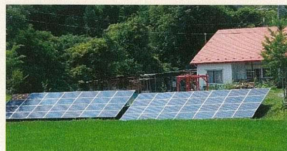
一関市民共同発電所なのはなソーラー2号機
