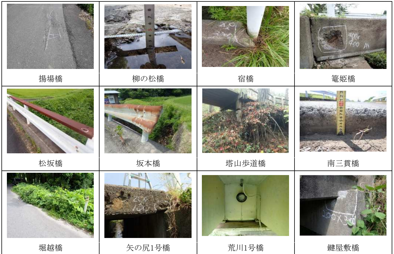
写真-3.2 小規模かつ軽微な劣化の状況写真
