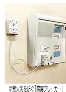
電気火災を防ぐ「感震ブレーカー」
