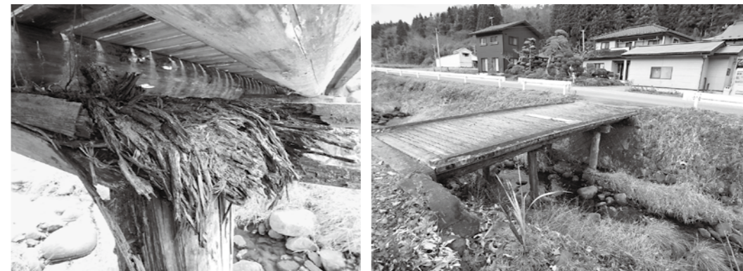
地域課題対応事業で修繕予定の外山入口橋(7区)
