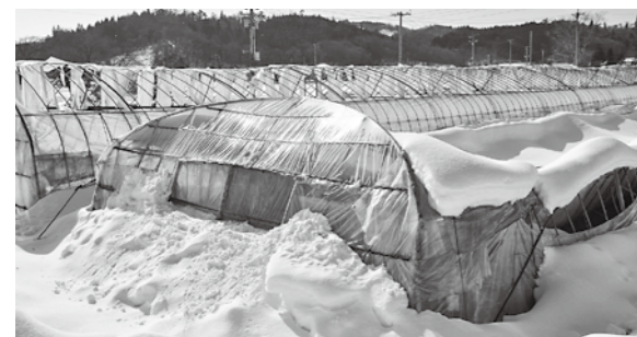
大雪で倒壊したパイプハウス
