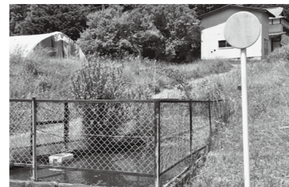
白い水利標識 地下水槽は特に課題がある
