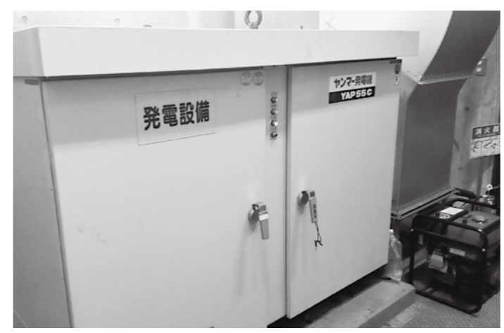
役場庁舎内に設置してある非常用発電機
